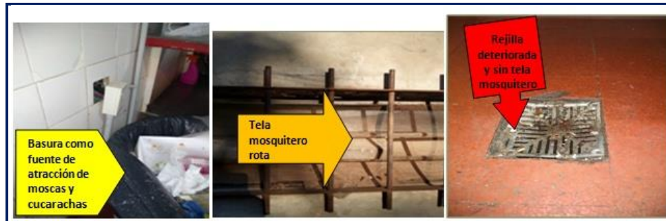
Vías de ingreso y constatación de presencia de Insectos:
